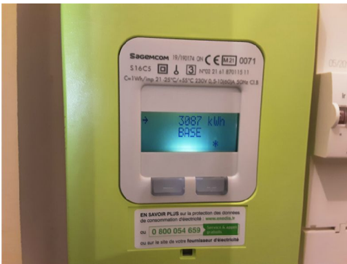
Compteur d'électricité HP
