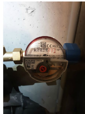
Compteur eau chaude
